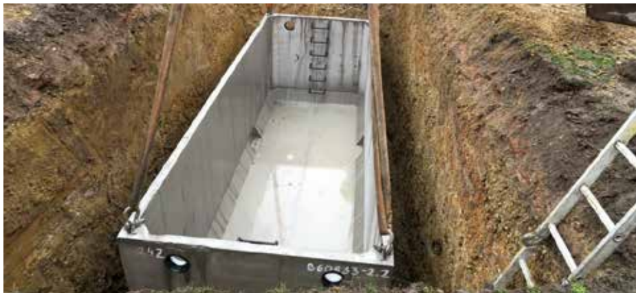
Betonová podzemní nádrž v ZŠ Jílovská má objem zhruba 24 000 litrů.
